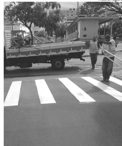
A sinalização auxilia na redução de acidentes
