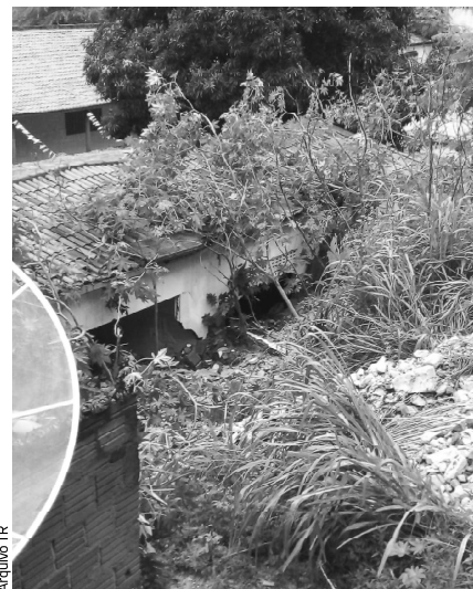
Creche foi interditada devido a desabamento
